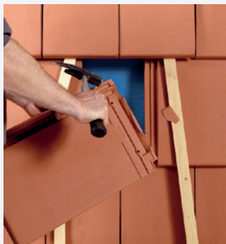
5. Neem een nieuwe pan en verwijder lokaal de opstand van de kopsluiting.
