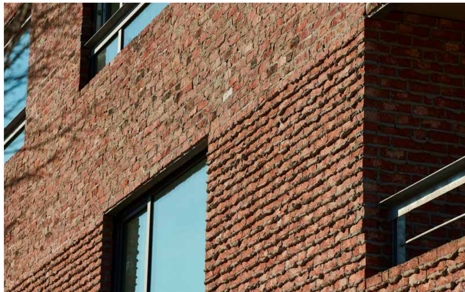
De nieuwe Terca Patrimonia Neo Romaans gevelstenen op de onderste verdiepingen werden gevoegd met een mortelbaard, de recuperatiegevelstenen op de bovenste verdiepingen werden geplaatst met een doorstrijkmortel.
